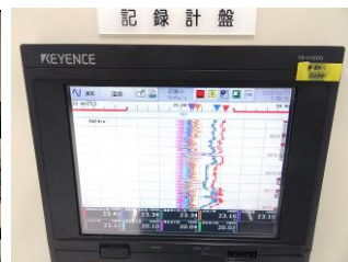
地下工場の温度記録計
